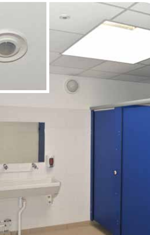
Sanitaire de la salle des " Pierres vives " : éclairage économique asservi à la présence
